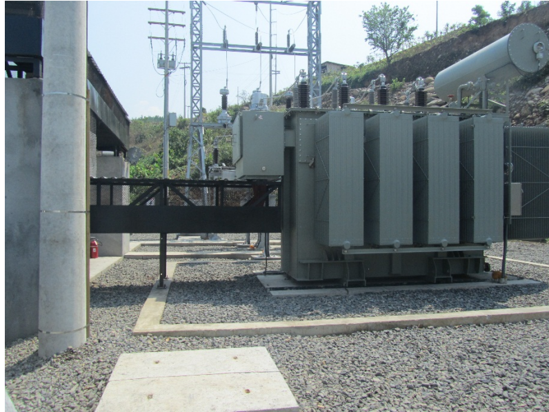
Figura n° 19: Detalle de pasarela para cableado de Alta Tensión y Transformador de Potencia.
