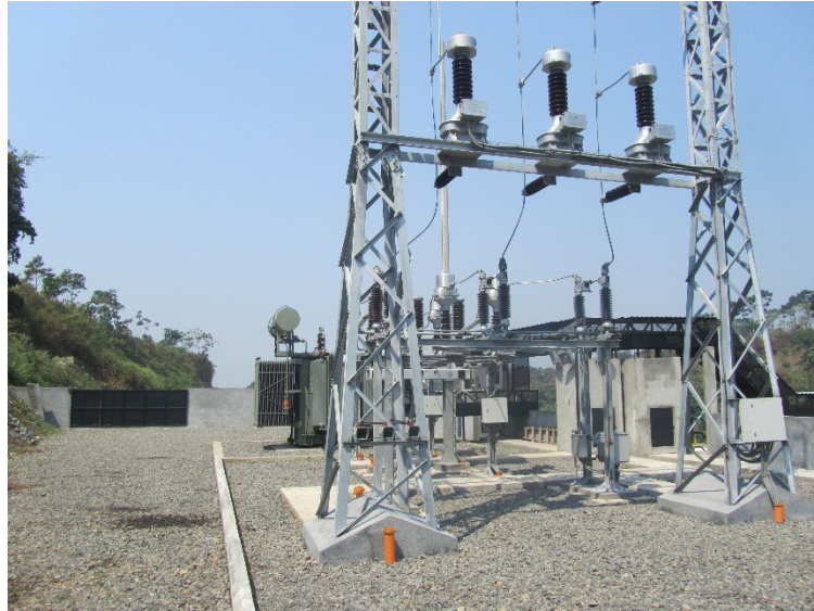
Figura n° 17: Detalle de pasarela para cableado de Alta Tensión y Transformador de Potencia.
