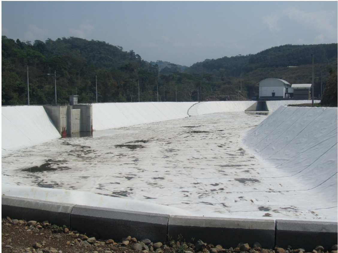
Figura n° 14: Balsa de desregulación. Vista desde la obra de desfogue y de la obra de aliviadero y desagüe al río Ocosito.
