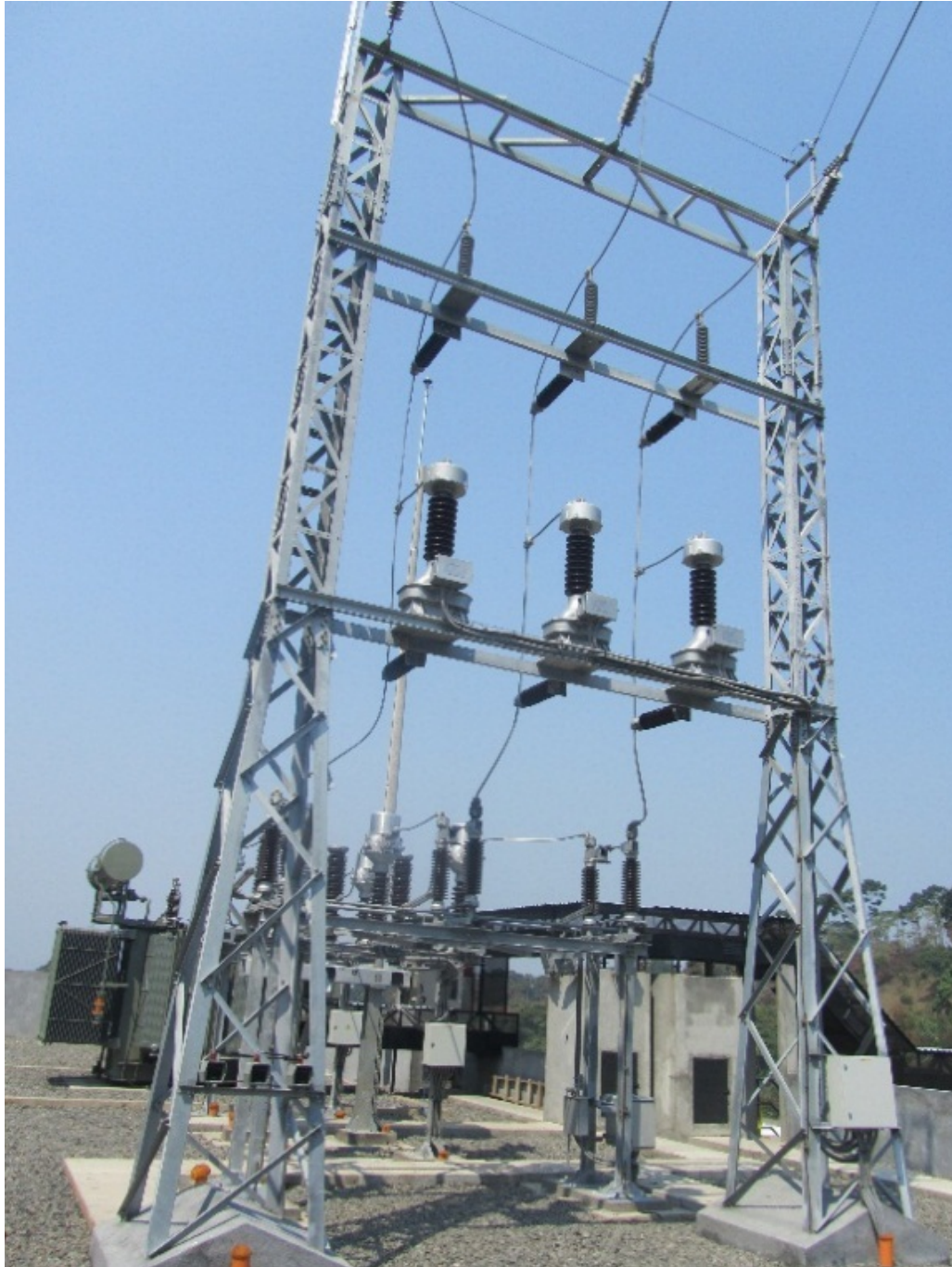
Figura n° 16: Detalle de aparamenta de la Sub. Elevadora.
