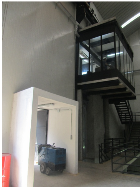
Figura n° 10: Vista de la sala de control sobre el foso de las turbinas y acceso peatonal.
