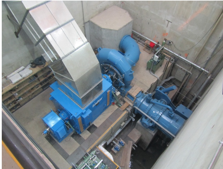
Figura n° 7: Vista del foso de la turbina, generador, válvula y equipos.
