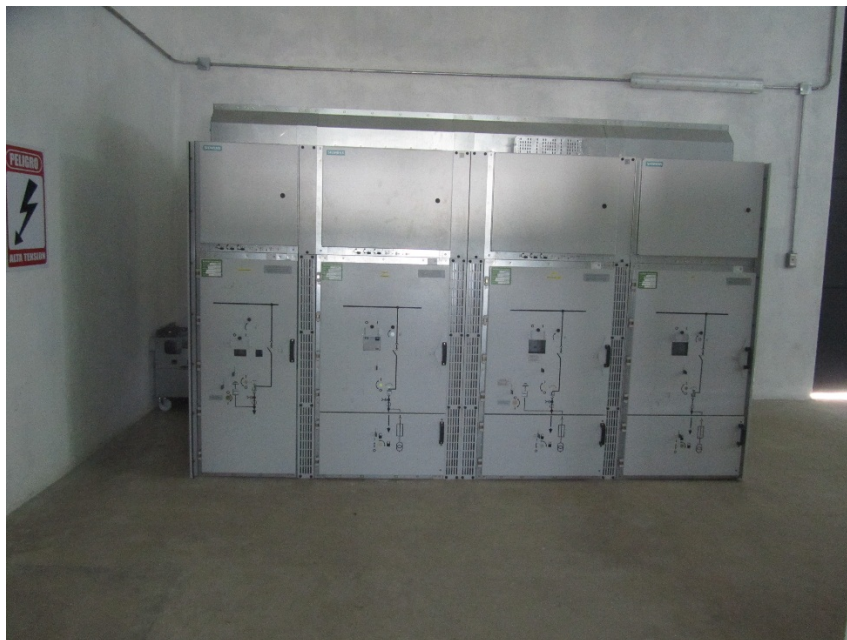
Figura n° 12: Vista de las Celdas de A.T. de la planta alta del edificio de control.
