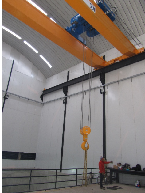
Figura n° 11: Vista del puente grúa de 50t para montaje y mantenimiento.
