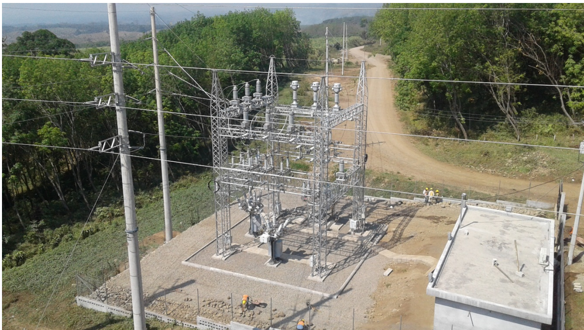
Figura n° 20: Vista general de aparamenta de la Subestación de Maniobra y Edificio de Control.
