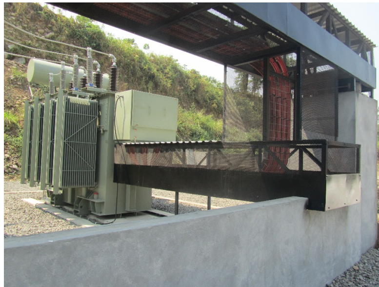
Figura n° 18: Detalle de pasarela para cableado de Alta Tensión y Transformador de Potencia.
