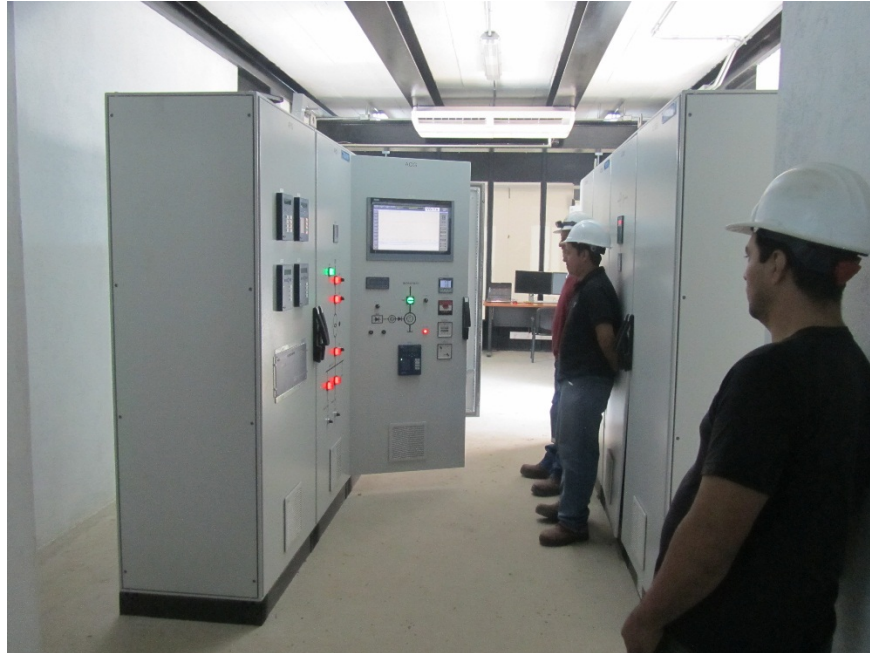
Figura n° 13: Vista de las Celdas de M.T y B.T y armarios de control.
