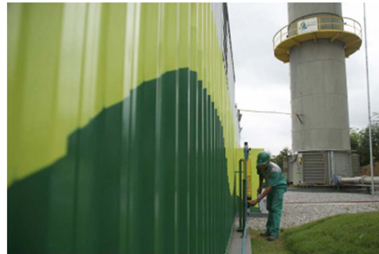
Landfill Gas Collection
